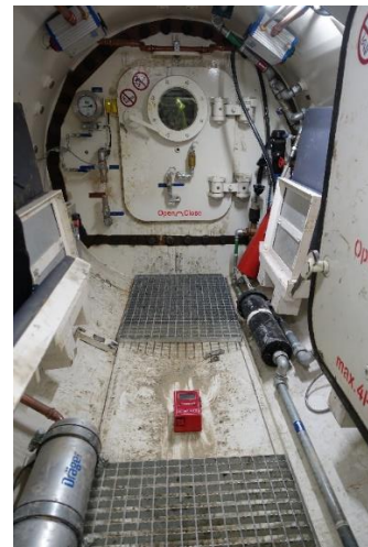
Figure 2 : Lyon-MetroB. Capteur dans un sas du tunnelier.
